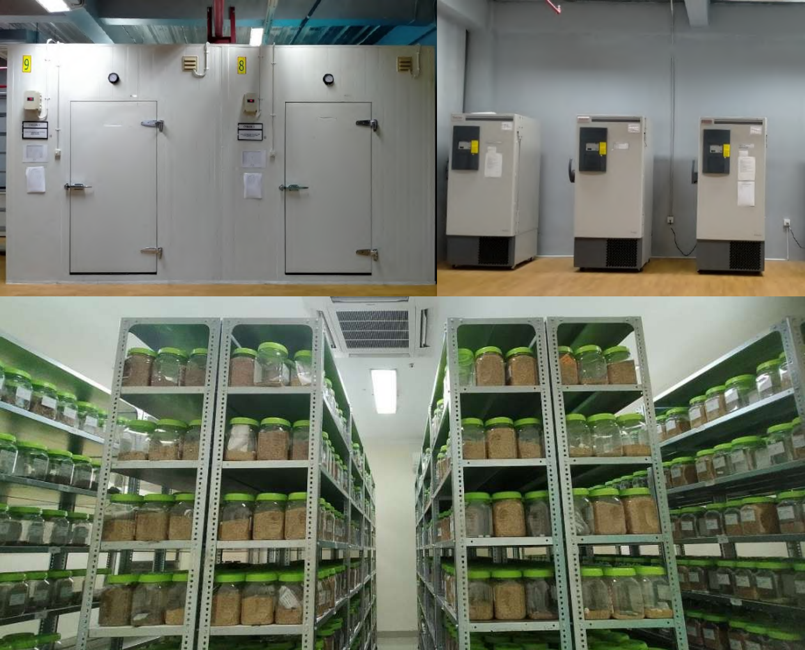
Gambar 2.14 Fasilitas Penyimpanan Jangka Pendek, Jangka Panjang, dan Fasilitas Safety Duplication (Sumber: BBPSI Biogen)
