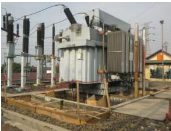
Travo Eksisting Gardu Induk Krapyak-Kota Semarang Sumber : Joint site visit MOF dan Bappenas
