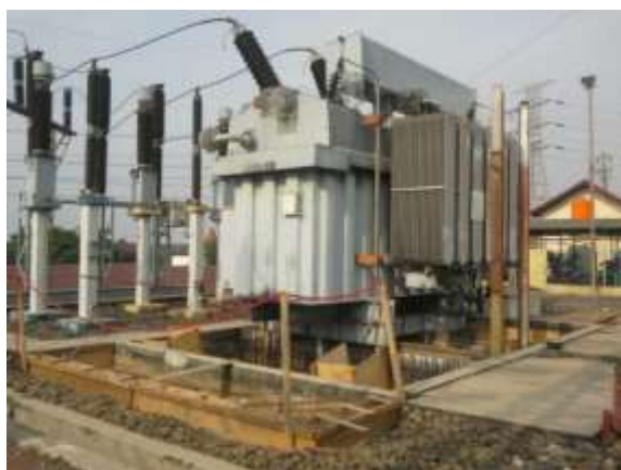
Travo Eksisting Gardu Induk Kranyak-Kota Semarang Sumber : Joint site visit MOF dan Bappenas
