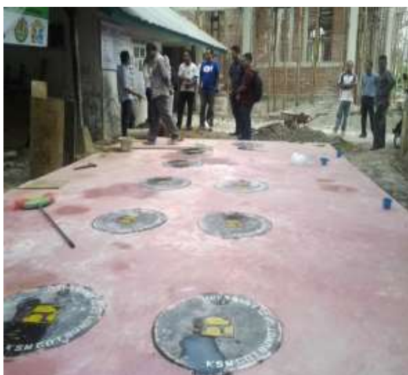
Pembangunan IPAL Komunal KSM Cot Bunot, Kecamatan Barona Jaya, Kabupaten Aceh Besar
