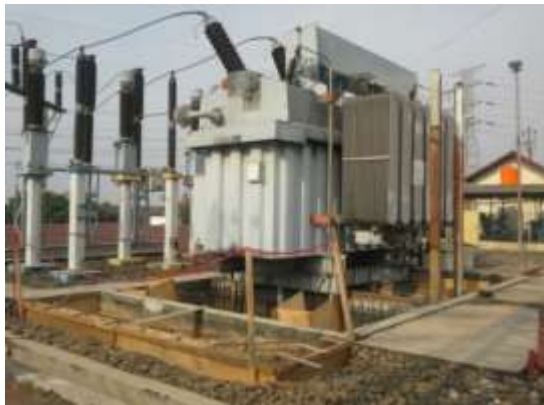
Travo Eksisting Gardu Induk Krpyak-Kota Semarang Sumber : Joint site visit MOF dan Bappenas
