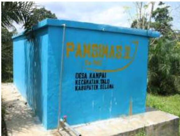
Reservoir Air Bantuan Program PAMSIMAS III di desa Kampal, Kecamatan Talo, Kecamatan Talo, Kabupaten Seluma, Provinsi Bengkulu
