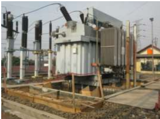
Travo Eksisting Gardu Induk Krapyak-Kota Semarang Sumber : Joint site visit MoF dan Bappenas
