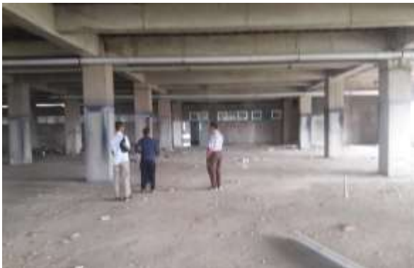
Kondisi Gedung RS Unhas
