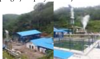
Gambar 3. Lokasi PLTP di Desa Ulumbu, Kab Manggarai, NTT
