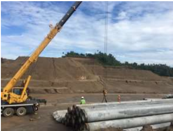
Swampy Area, Pengadaan Tiang Pancang Sumber : Kementerian Pekerjaan Umum dan Perumahan Rakyat
