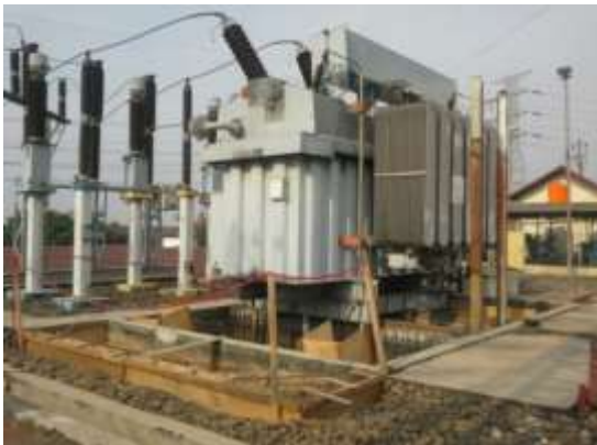
Travo Eksisting Gardu Induk Krapyak-Kota Semarang Sumber : Joint site visit MOF dan Bappenas
