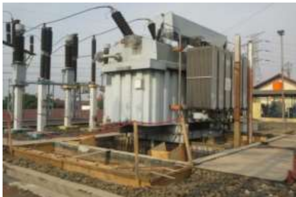
Travo Eksisting Gardu Induk Krapyak-Kota Semarang Sumber : Joint site visit MOF dan Bappenas
