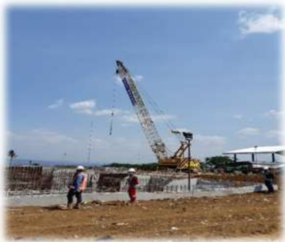
Pelaksanaan Pembangunan TPA Supit Urang Kota Malang Sumber: Kunjungan Lapangan Kemenkeu - Bappenas)
